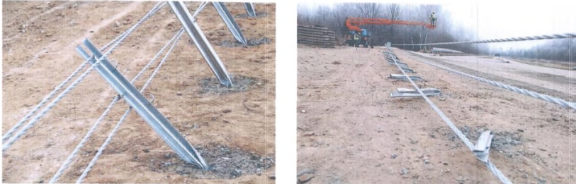
Рисунок 6 – Деформация открытых стоек
