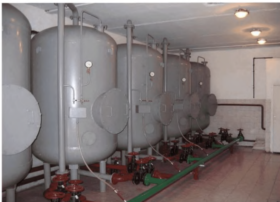
Рисунок 18 - Очистное сооружение индивидуального проектирования (фильтры 1-3 ступеней очистки)
