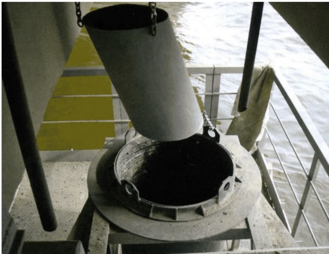
Рисунок 27 - Комбинированный фильтрующий патрон (установка на опоре моста)
